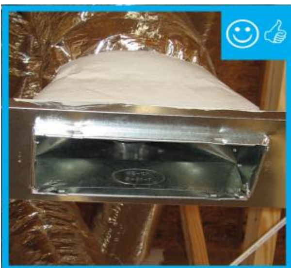
Display Image: ES HVAC QIRC 3.1_PG44_65i_102811.jpg
